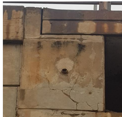
Situation normale Tablier désolidarisé du muret cache culée 2 du pont 2
