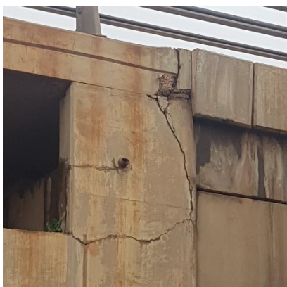
Situation anormale Tablier posé sur le muret cache culée 2 du pont 1
